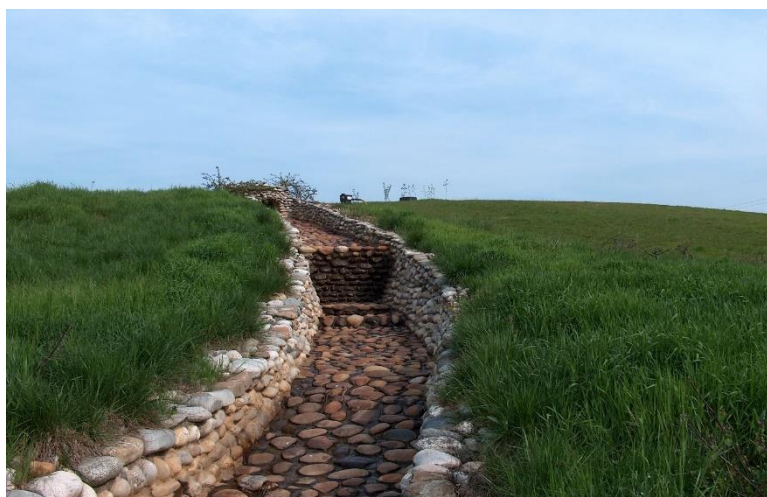
Fig. 9: Discarica di Cavenago-canalina di raccolta per acque meteoriche
